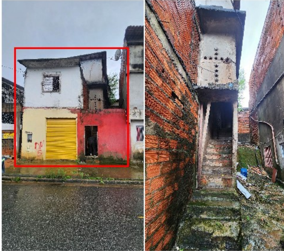
Fotos 2 e 3 – Fotos da fachada frontal e entrada lateral do imóvel localizado na Rua Uchôa, 72 – Vila Dirce – Carapicuíba/SP. O imóvel em questão está interdito pela Defesa Civil e deverá ser demolido.
